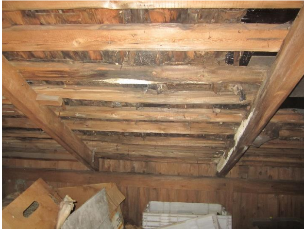
Kuva 10. Vesikatto on vuotanut.
