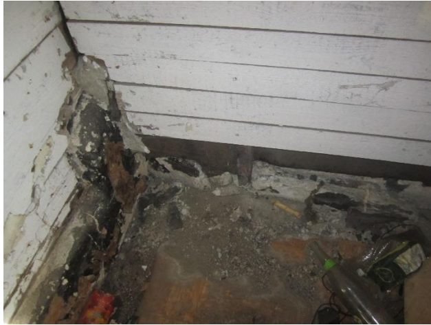
Kuva 5. Kellarikerroksessa on runsaasti mikrobivaurioitunutta materiaalia.
