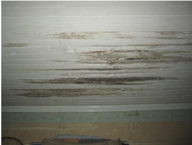
Kuva 9. Keskikerroksen katossa on kosteusvaurioita.
