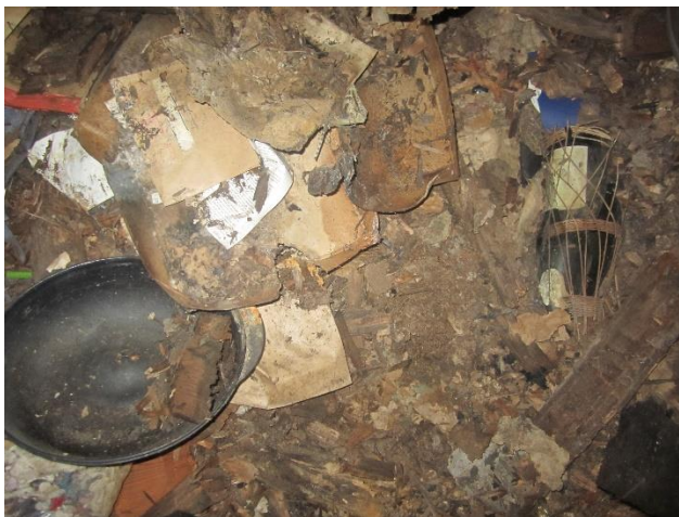
Kuva 12. Yläpohjassa on paljon ylimääräistä jätettä.
