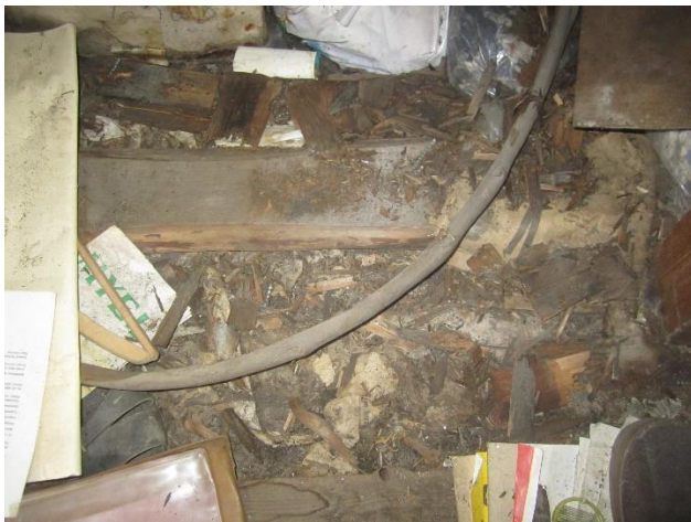
Kuva 11. Ylemmässä välipohjassa on kosteusvaurioita.
